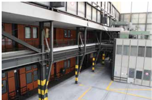
Abb. 39 Blick auf Galerie als Zwischenbau zwischen Hangar N1 und Annex N1a, rechts westlicher Einbau
